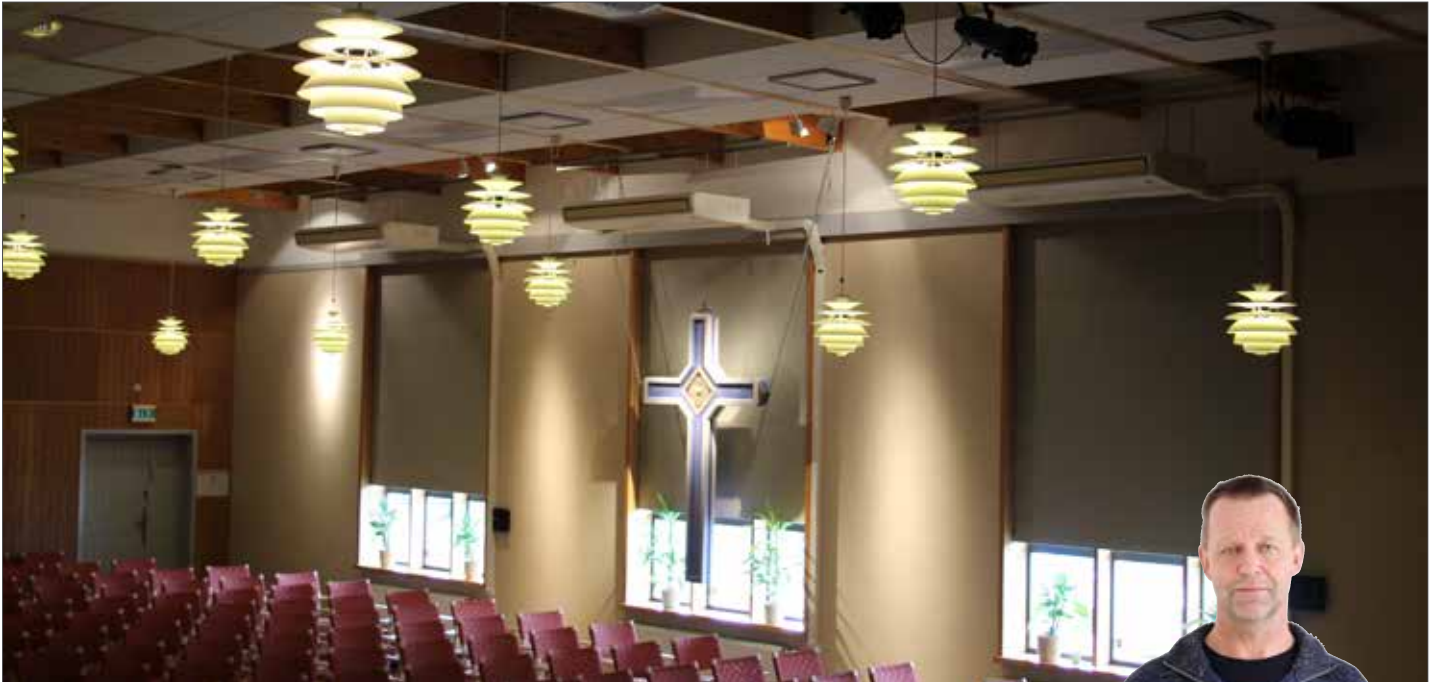
S:t Staffans församling har installerat luftkonditionering i kontorslokaler, serverrum och samlingsal.
