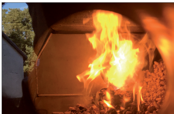
Uppstart av pelletspanna. Brinnande pellets i brännkammaren.
